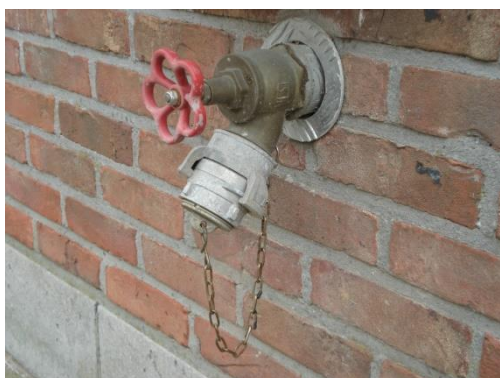
Figuur 19: Muurhydrant of DSP-mondstuk Ø 45 mm (alleen)
